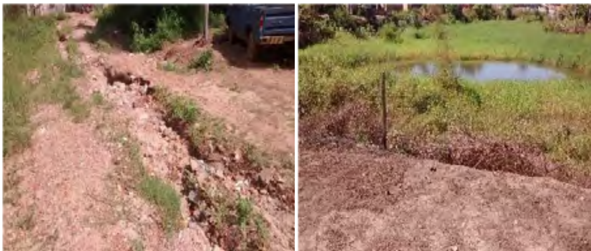
Figura 2. Erosão do solo nas margens dos igarapés Açaizal e Gabriel. São Domingos do Araguaia -PA.
