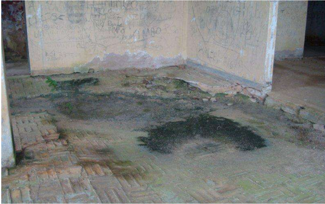
Figura 9. Danos causados pelo intemperismo e vandalismo em uma das construções. Fonte: Roberta Silva, 2011.
