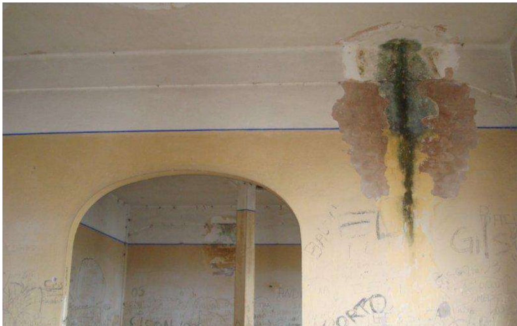
Figura 8. Danos causados pelo intemperismo em uma das construções. Fonte: Roberta Silva, 2011.
