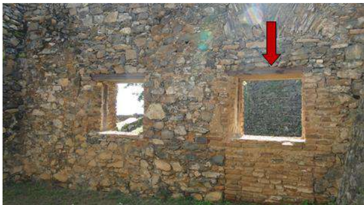
Imagem 12: Lacunas por ausência (esquadrias) e por adição (entaipamento do vão indicado): presentes em todo o forte.
