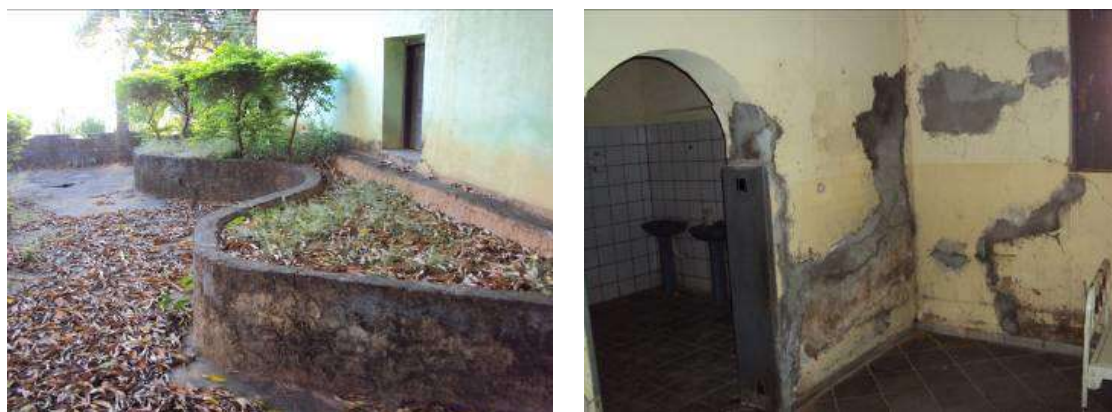
Figura 8 :Jardim da Fachada Sul e Umidade na Parede Externa. Fonte: Suyanne Paranhos Matos, 2013.
